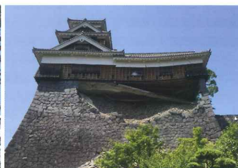
▲震災直後の熊本城本丸の被災状況(株大林組のHPから)
